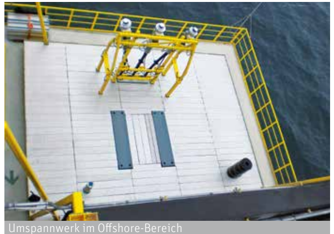
Umspannwerk im Offshore-Bereich
